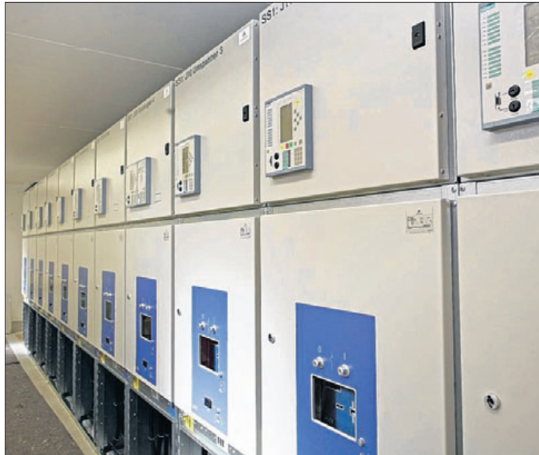
Moderne Energieversorgung: Die Mittelspannungsschaltanlage.
